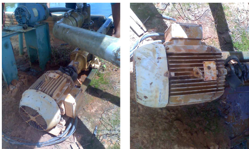
FIGURA 6. Motores com acoplamentos danificados e assentados ao chão
