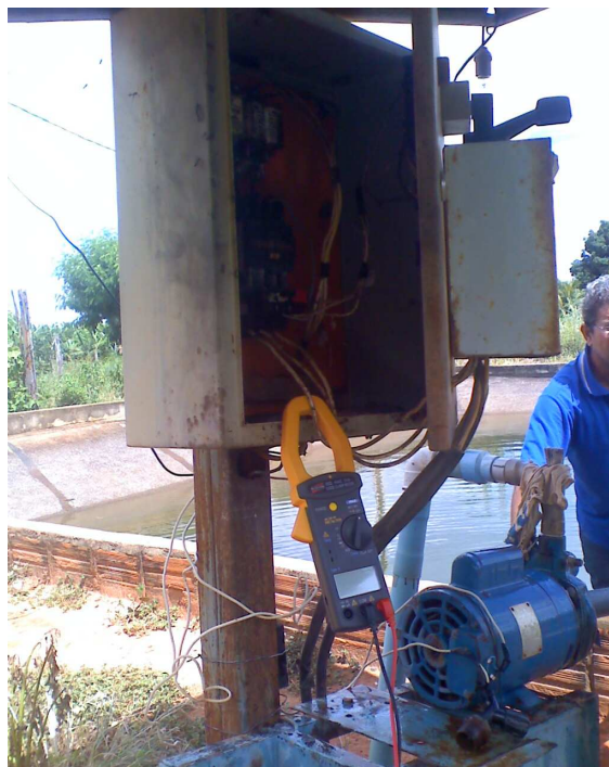
FIGURA 5. Wattímetro alicate instalado em uma das fases.
